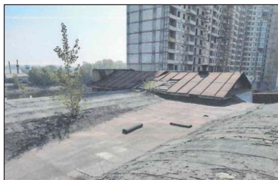
Рисунок 9 – Участок кровли (разрушение рулонной кровли, произрастание поросли)
