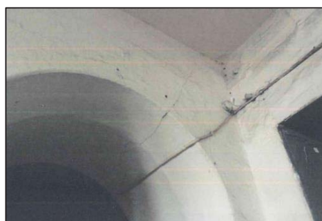
Рисунок 5 – Фрагмент помещения первого этажа (трещина в арочном проеме)
