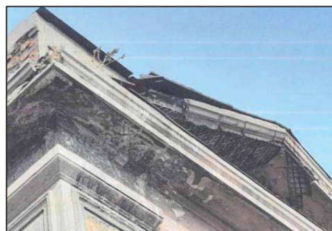
Рисунок 6 – Фрагмент фасада с разрушениями карниза и стены
