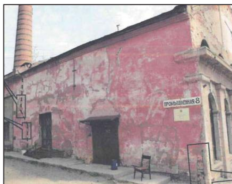
Рисунок 4 – Фрагмент фасада с трещинами в стене шириной раскрытия до 5 мм
