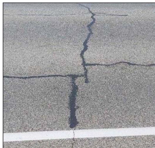
Рисунок 2 – Дефекты покрытия до капитального ремонта на ПК22+00
