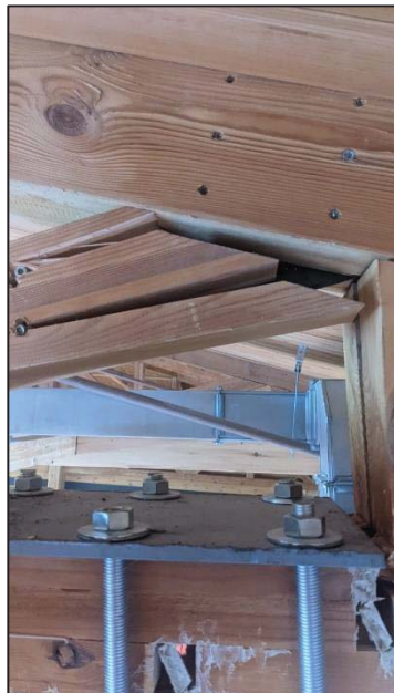
Рисунок 4 – Промежуточные узлы фермы верхнего и нижнего пояса. В трех нижних досках вместо соединений на зубчатый шип – отверстия
