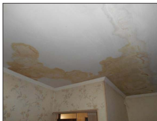
Рисунок 1 – Повреждения потолка в квартире жилого дома по ул. Матросова, 15-14 в г. Барнауле
