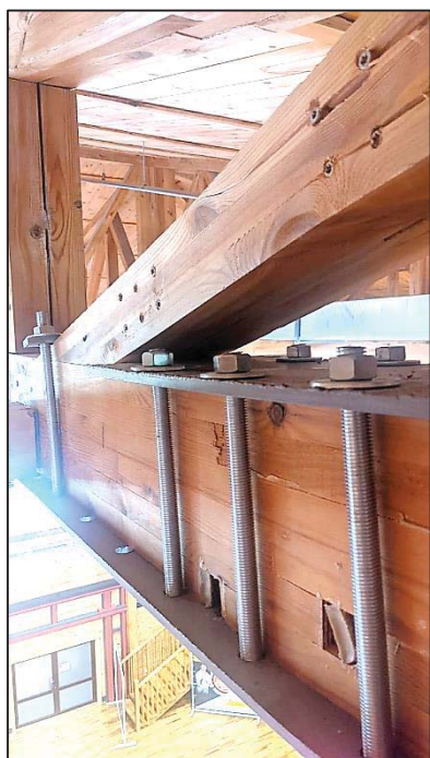
Рисунок 3 – Опорный узел фермы после усиления. В двух нижних досках вместо соединений на зубчатый шип – отверстия
