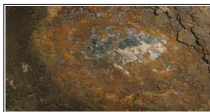
Рисунок 4 – Прогар коллектора, подверженного эксплуатации при высоких температурах
