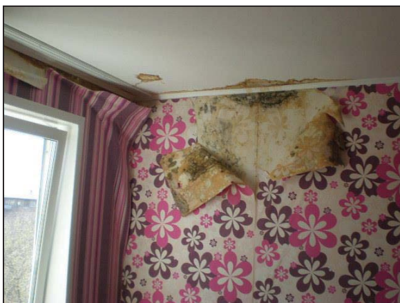
Рисунок 3 – Образование грибка в квартире жилого дома по ул. Островского, 31-45 в г. Барнауле в результате систематических протечек кровли
