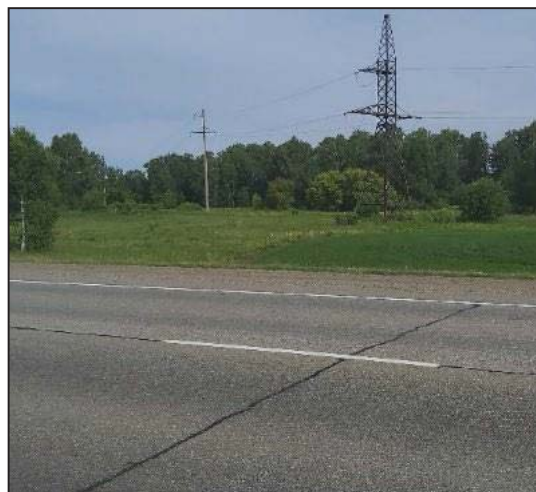
Рисунок 1 – Дефекты покрытия до капитального ремонта на ПК1+00
