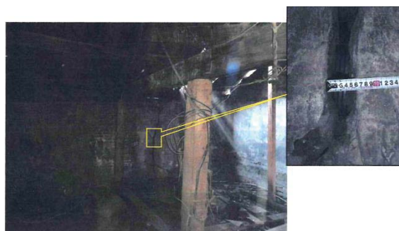
Рисунок 8 – Фрагмент чердака (аварийное усиление подпорками, трещина в стене шириной раскрытия до 62 мм)
