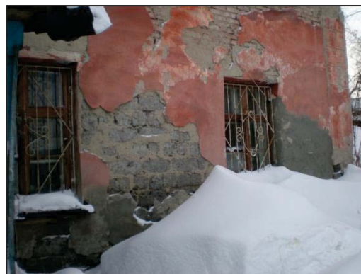
Рисунок 1 – Разрушение фасадной штукатурки от времени жилого дома по адресу: г. Барнаул, ул. 2-я Строительная, 58
