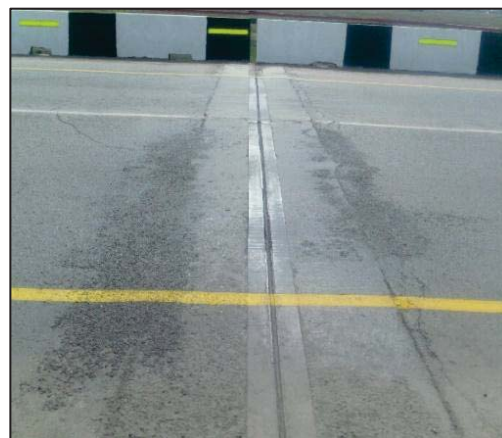
Рисунок 1 – Дефекты покрытия проезжей части
