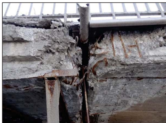
Рисунок 1 – Разрушение мостовых конструкций в месте расположения водоотводной трубки с моста
