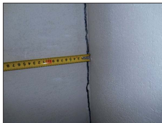
Рисунок 2 – Трещина в несущей стене вследствие нарушения строительной технологии устройства каменной кладки жилого дома по адресу: г. Барнаул, пер. 1-й Садовый, 44
