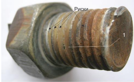
Рисунок 3 – Фрагмент узла, представленного на рисунке 2, б с деформированной резьбой, где 1 – линия плоскости шлифа, представленного на рисунке 4
