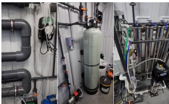
Рисунок 6 – Оборудование установки для очистки шахтных вод, установленное в блок-контейнере
